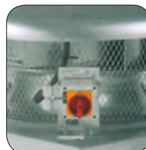
Διακόπτης ON/OFF πάνω στον εξαεριστήρα
